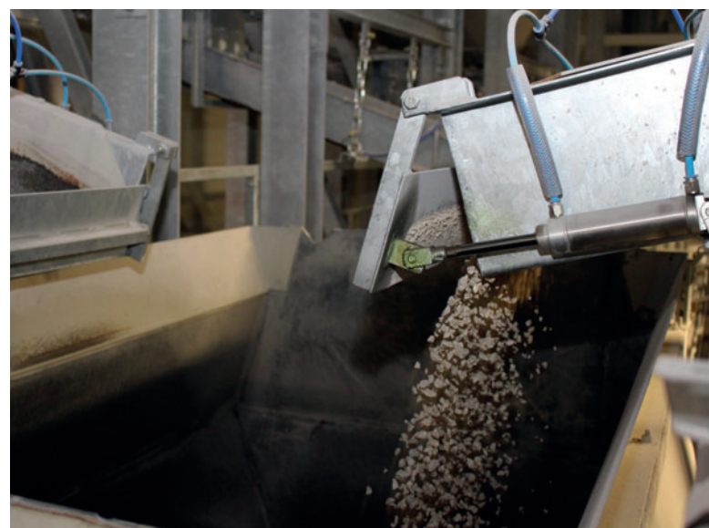
Точное дозирование заполнителей в передвижные весы осуществляется с помощью виброток и затворов
